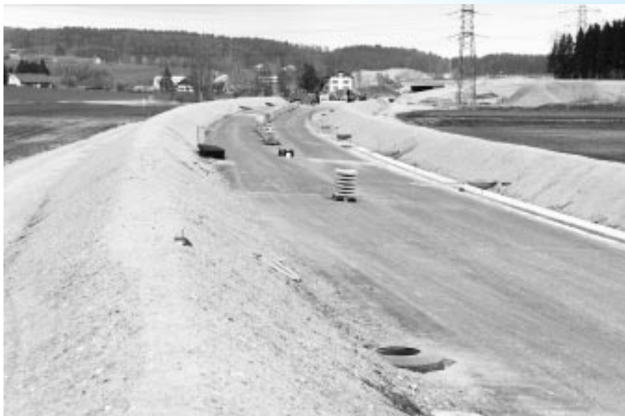
Bau der A4: Deutlich sichtbar sind die seitlich aufgeschütteten Erdwälle zum Schutz der Umgebung vor Lärmimmissionen.
