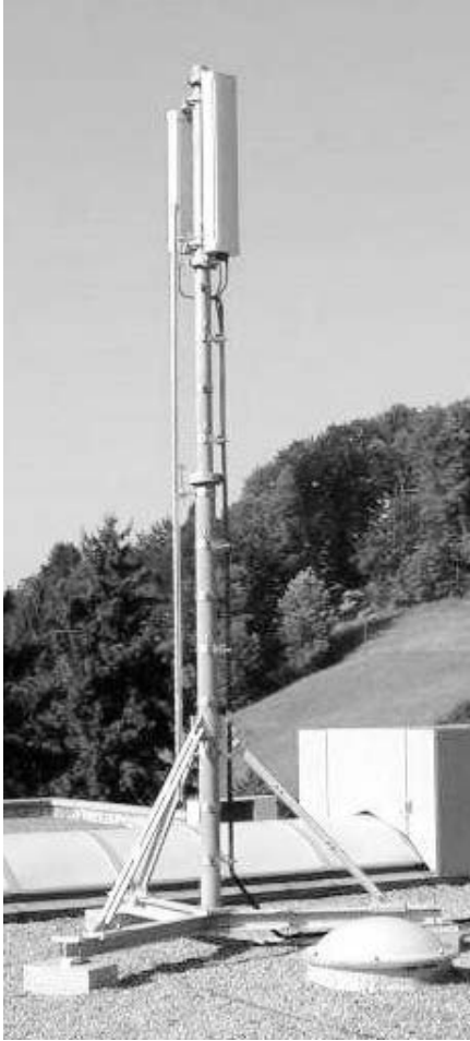
Ist eine Antenne in Betrieb, kann mittels Messungen überprüft werden, ob die im Baugesuch prognostizierten Strahlenwerte eingehalten werden.
