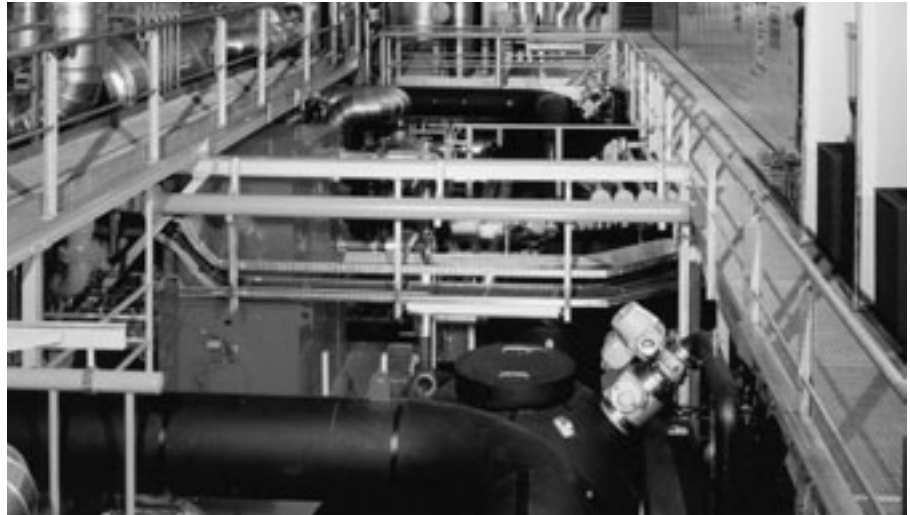
Die Wärmepumpe Walche, die grösste der Schweiz, gewinnt Wärme aus Limmatwasser. Quelle: AWEL
