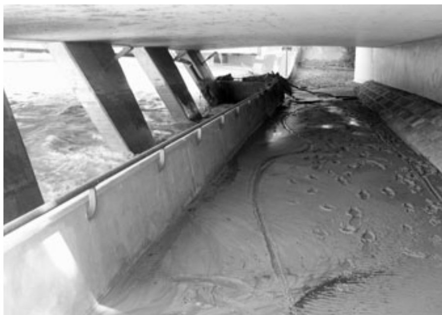
Eine Unterführung bei der Allmend Brunau an der Sihl nach dem Hochwasser im August 2005: Noch steht das Wasser viel höher als üblich. Gut sichtbar ist der abgelagerte Sand sowie Treibholz.
