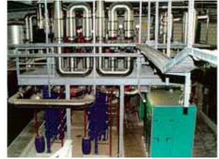
Ein neues System, erlaubt auch eine Wärmerentnahme ausserhalb des Kanals. Es wurde bisher bei zwei Kläranlagen in der Schweiz zur Klärschlamm-trocknung eingesetzt.
