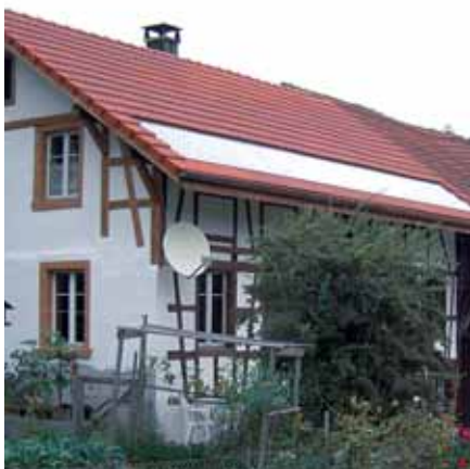
Kleinflächige Solaranlage im Traufbereich. Quelle: Baku
