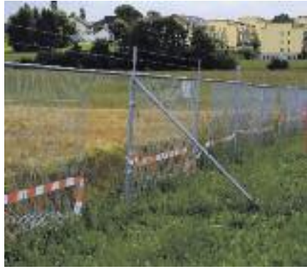
Zerstörter Zaun, 13. Juni 2008.
