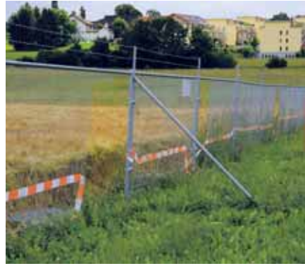
Zerstörter Zaun, 13. Juni 2008.
