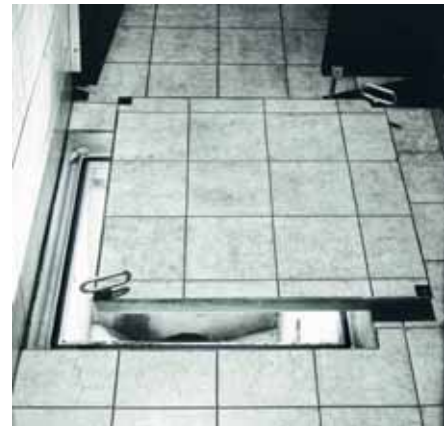
Ein richtiger Schachtdeckel verhindert Eindringen von Radon in Wohnräume.
