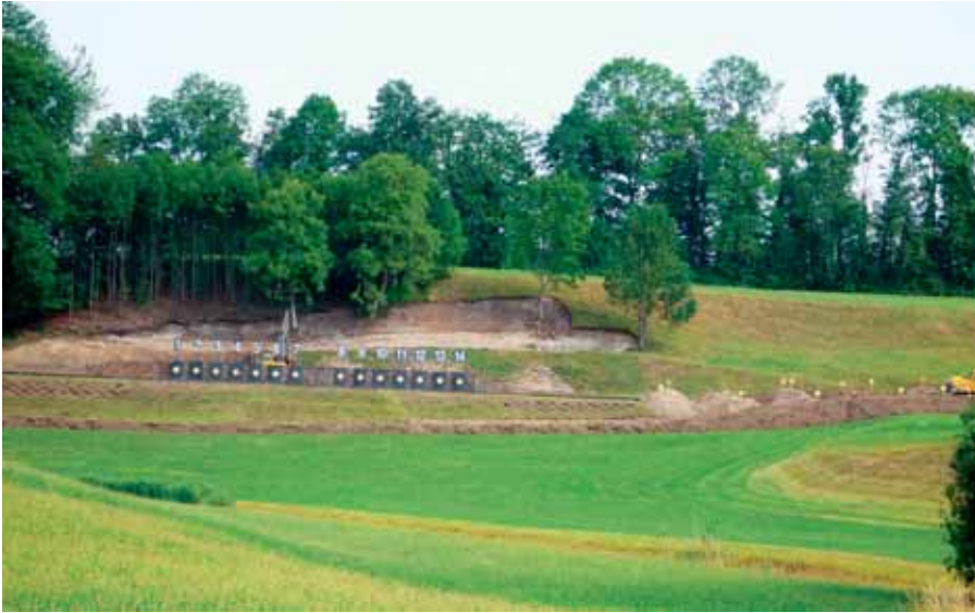
Sanierung des natürlichen Kugelfangs durch Abtragen und Sortieren des bleibelasteten Erdreichs (Dekontamination).
