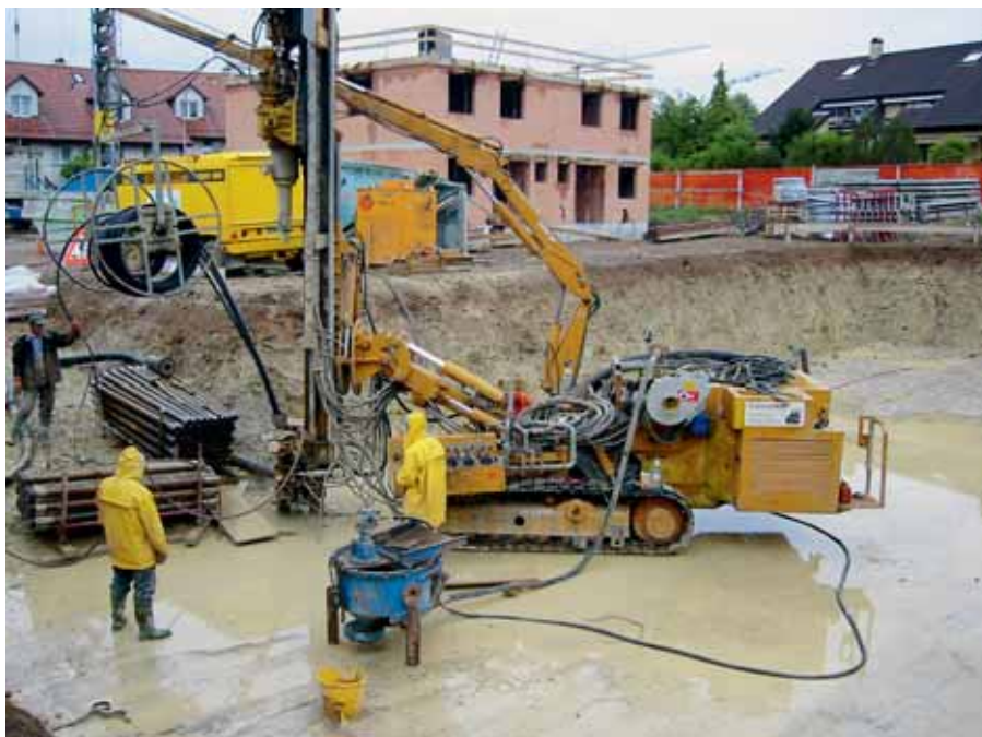
Erdwärmesondenanlagen sind bei Neubauten von Ein- und Mehrfamilienhäusern heute die häufigste Heizquelle.
