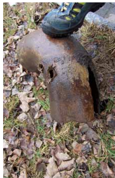
Tauchbögen sind wesentlicher Bestandteil eines Schlammsammlers und müssen sorgfältig wieder eingebaut werden.
