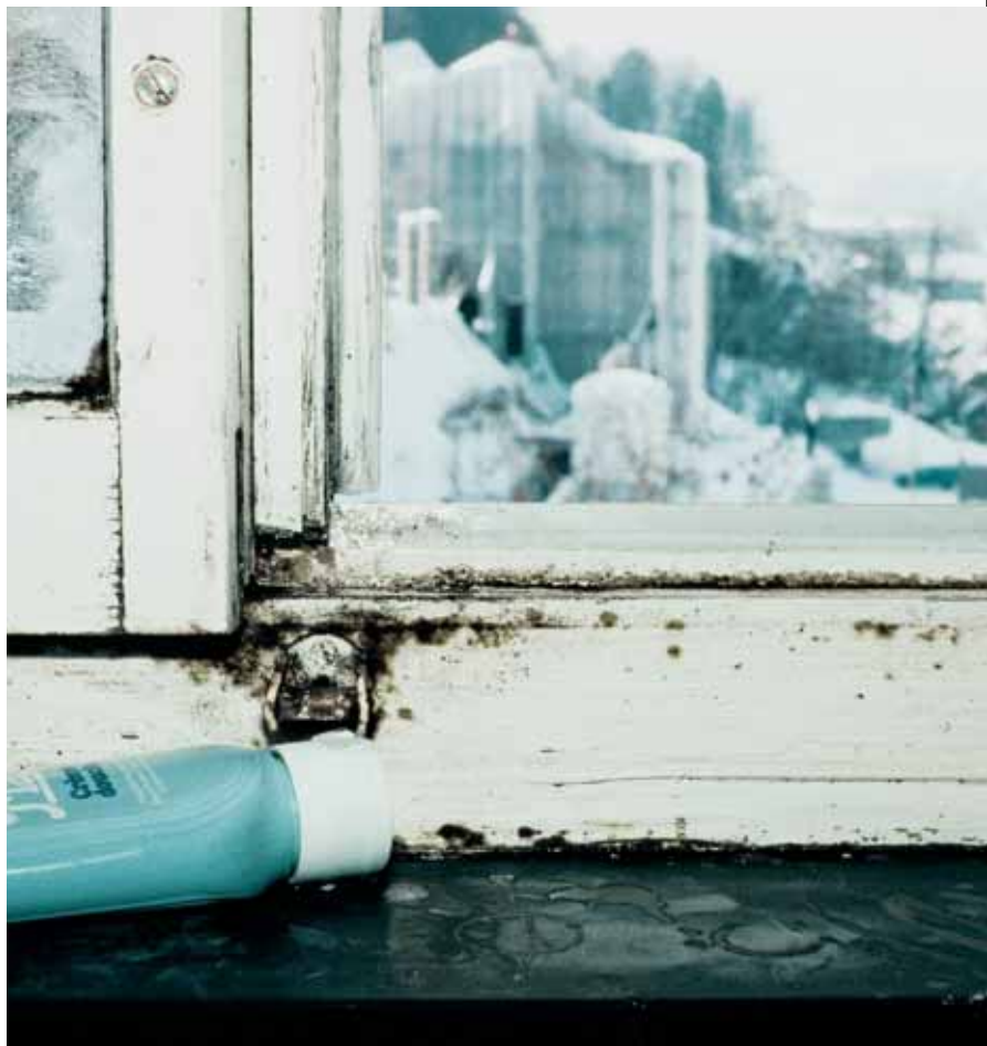
Kühle, feuchte Orte und Ecken sind für Schimmel prädestiniert. Quelle: EMPA
