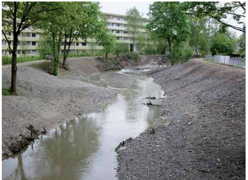
Der Chriesbach in Dübendorf vor (oben) und nach der Revitalisierung im Mai 2013 (unten). Die durchgehende Uferverbauung aus Blockwurf wurde entfernt, die Uferböschung stellenweise abgeflacht und dem Bach eine natürlichere Linienführung gegeben. Zudem wurde der Mündungsbereich in die Glatt naturnah gestaltet. So können sich auch wieder Organismen mit höheren Ansprüchen an den Lebensraum im Chriesbach ansiedeln.
