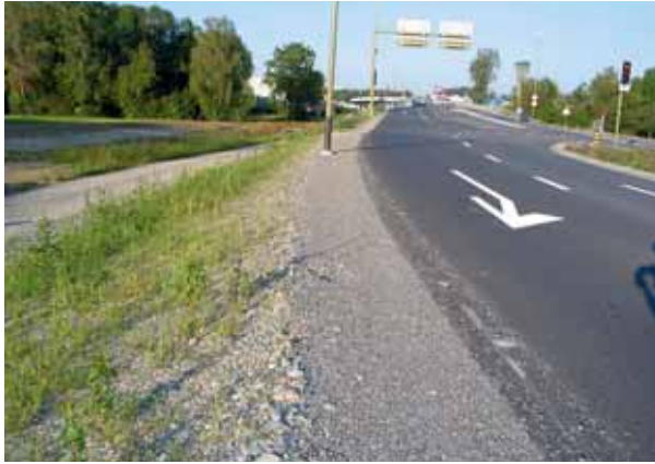
Entwässerung über die Strassenschulter vermeidet Probleme mit Randabschlüssen und Schachteinläufen. Quelle: Simon Gaus
