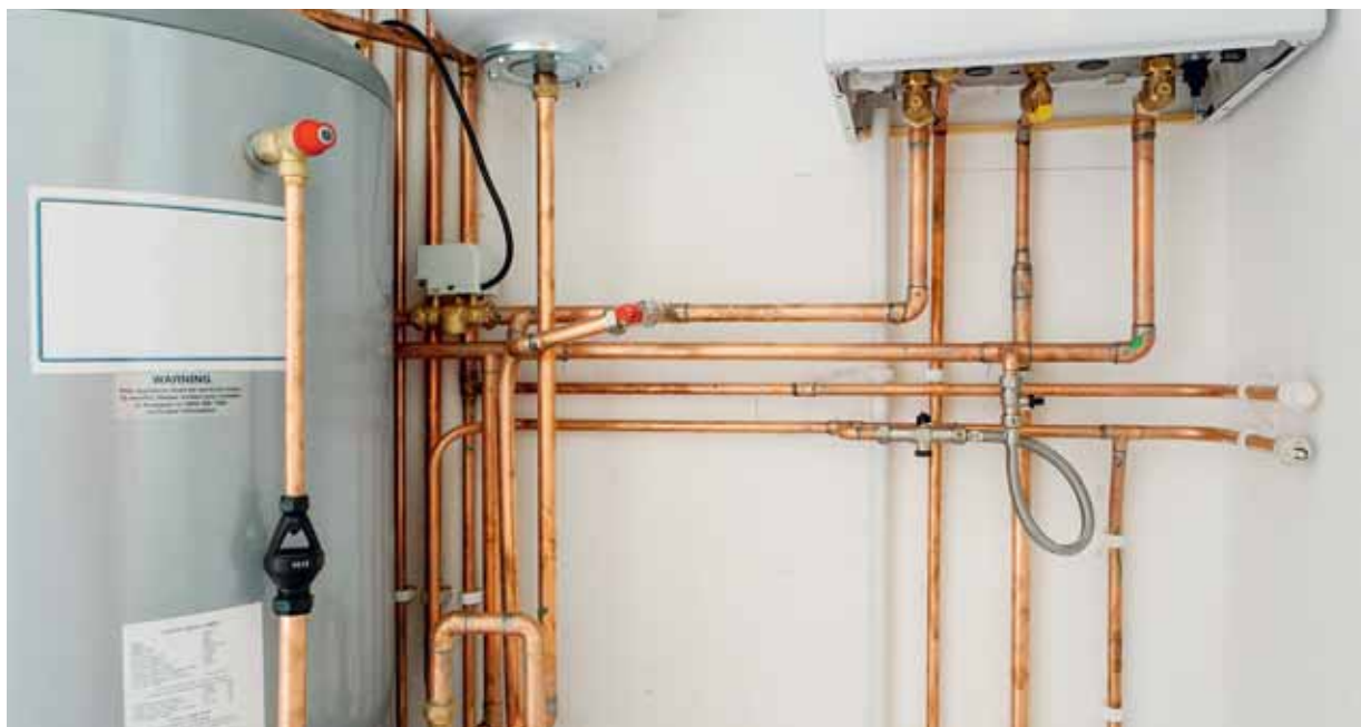
Bei älteren Bauten entfallen vier Fünftel der neu installierten Wärmeerzeuger auf einen «reinen» Ersatz. 54 Prozent davon sind noch immer fossil befeuerte Heizkessel. Quelle: Flickr, CC
