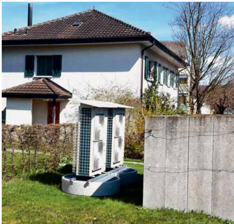
Aussen aufgestellte Luft/Wasser-Wärmepumpe in einem Wohngebiet. Die Gefahr von Lärmbelastigungen ist erhöht. Es ist eine besonders gute Planung erforderlich. Quelle: TBA/Fachstelle Lärmschutz
