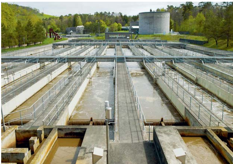
Bei der Abwasserbelastung wurden gute Fortschritte erzielt. Noch werden die Mikroverunreinigungen aber nicht ausreichend durch die Zürcher ARA zurückgehalten. Quelle: AWEL, GS
