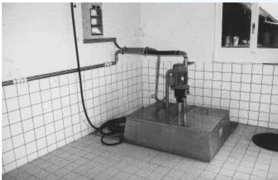
An Futterküchen zur Verarbeitung von Küchenabfällen zu Tierfutter sind hohe Anforderungen zu stellen: Hier ein gutes Beispiel einer neuen Küche mit Kocher.
