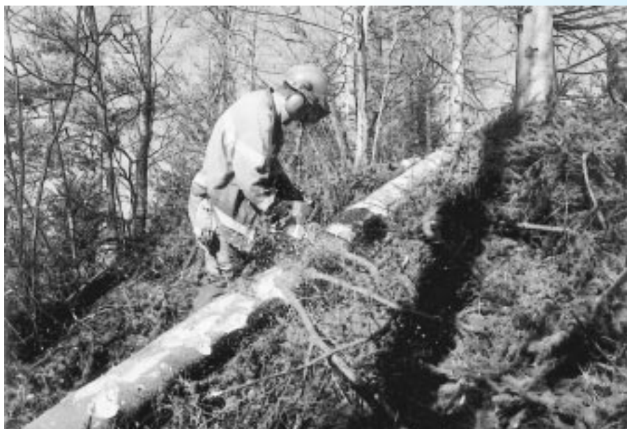
Pflege der Waldfläche zwischen Autobahn und SBB. Grünflächen machen fast 57 Prozent des Autobahnperimeters aus, davon zwei Drittel Gehölze.
