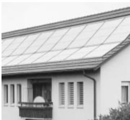
Auf dem Dach der Alterswohnungen in Rheinau wurden 1997 97,5 m 2 Sonnenkollektoren für eine Warmwasseranlage installiert.
