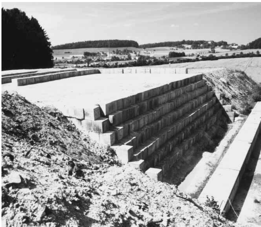
Reststoffdeponiertes Material wie diese zementverfestigten Rückstände aus der Rauchgasreinigung von Kehrichtverbrennungsanlagen geben zumindest kurzfristig keine die Umwelt beeinträchtigenden Stoffe ab. Längerfristig ist das Umweltverhalten unbekannt. Deshalb wurden die Rohstoffe dem Massenstrom MS-8 und nicht MS-7 zugerechnet.
