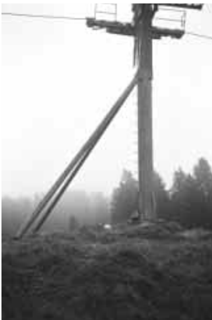
Dieser Seilbahnmast ist verzinkt und weist keine Deckschichten auf. Durch die Abwitterung wird direkt Zink abgetragen.
