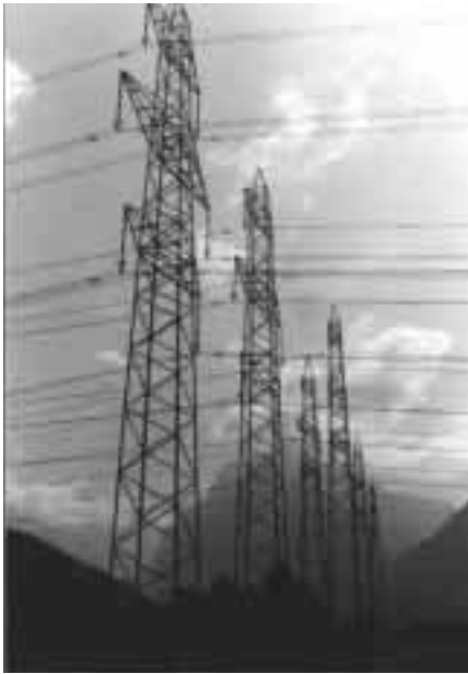
Diese Hochspannungsmasten sind verzinkt (240 kg/Mast). Die Zinkschicht ist mit Deckschichten vor der Abwitterung geschützt. Quelle: AfU Glarus
