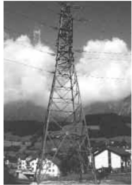
Ein mit Bleimennige geschützter Hochspannungsmast (Baujahr 1930) ist mit rund 70 Kilogramm Blei beschichtet. Quelle: AfU Glarus
