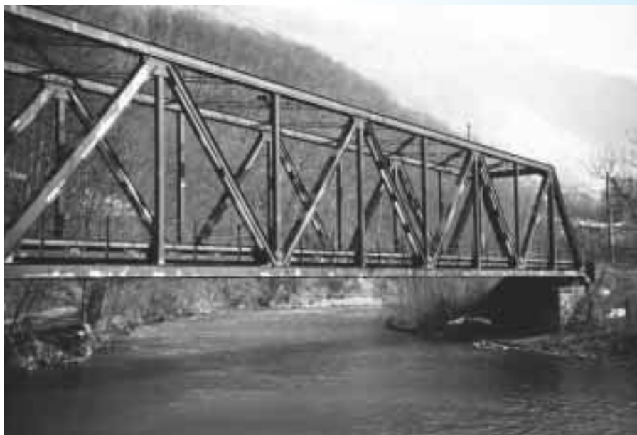
Diese Eisenbahnbrücke über die Linth (Baujahr 1912) ist mit etwa 750 Kilogramm Blei gegen Korrosion geschützt.
