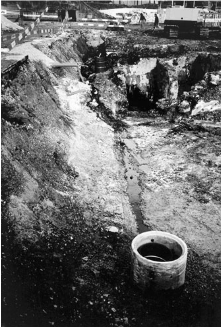
Ein Betriebsstandort wird saniert: Das zu entfernende Öl-Wasser-Gemisch fließt in einen Sammelschacht und wird abgepumpt.
