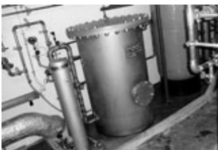
Der GEH-Kalk-Adsorber an der Universität Zürich erreicht für die Kupfer- und Zinkentfernung einen Wirkungsgrad von über 99%. Quelle: Aquaring Dällikon AG
