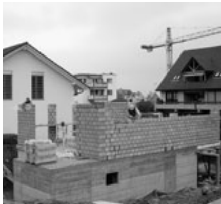
Das Gros der Baustellen befindet sich im dicht besiedelten Raum. Hier ist Lärmschutz besonders wichtig.
