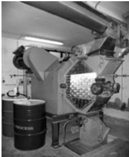
Pelletpresse in einem mittleren Holzverarbeitenden Betrieb (< 10000 Tonnen Jahresproduktion).
