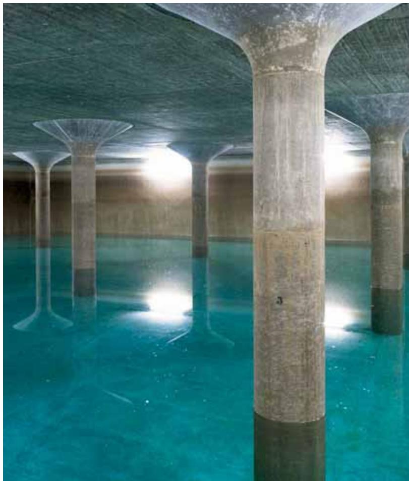
Die Gemeinden und Städte gewährleisten eine hohe Versorgungssicherheit mit qualitativ hervorragendem Trinkwasser. Im Bild Wasserreservoir in Hinwil. Quelle: Priska Ketterer, Luzern
