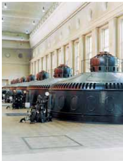
Die sieben Turbinen des Kraftwerks Eglisau Glattfelden nutzen das Gefälle des Rheins und treiben Generatoren an. Quelle: Axpo Holding AG
