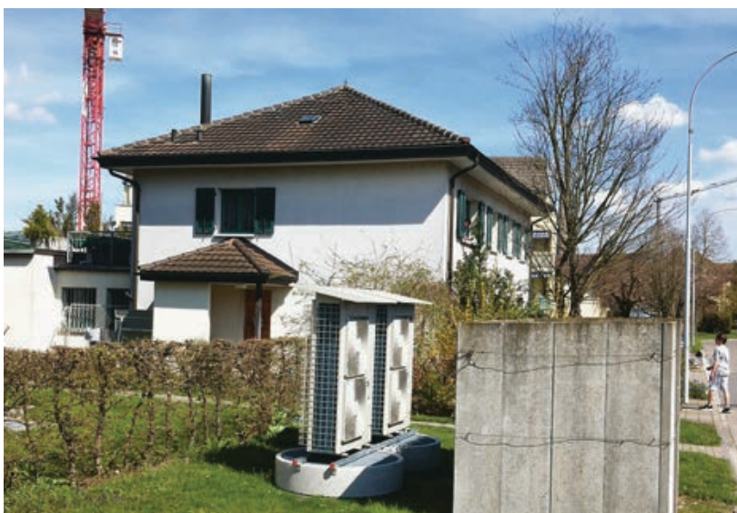
Für Anlagen ohne raumplanerisches Interesse wie Wärmepumpen haben Vorsorgemassnahmen, wie leise Geräte, Priorität.
