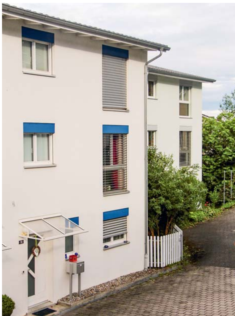
Verschattungen wie diese Lamellenstoren sollen die Sonnenstrahlung gar nicht erst ins Gebäude eindringen lassen.
