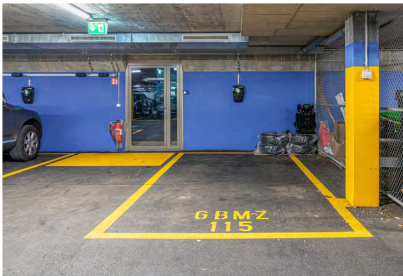
Zwei der insgesamt sechs Parkplätze, bei denen die Ladestation bereits installiert wurde. Weitere 18 Parkplätze sind mit einer Zuleitung versehen worden, sodass nur noch die Ladestation angebracht werden muss, wenn ein Bedarf gemeldet wird. Quelle: Savenergy Consulting / Georg Holubec
